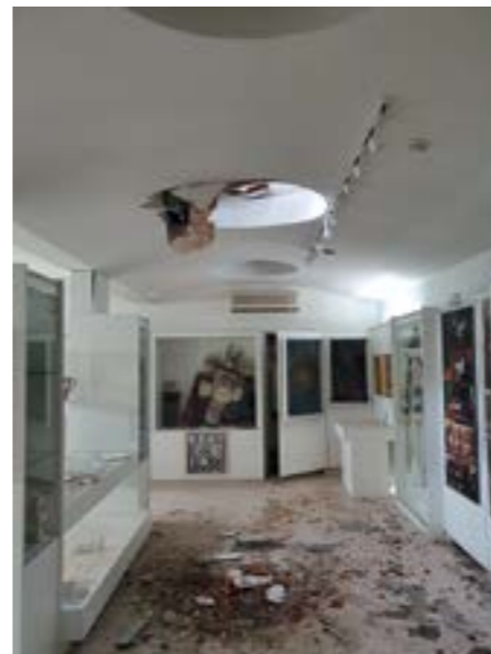
ZGRADA ŽIDOVSKJE OPĆINE ZAGREB OŠTEĆENA U POTRESU
