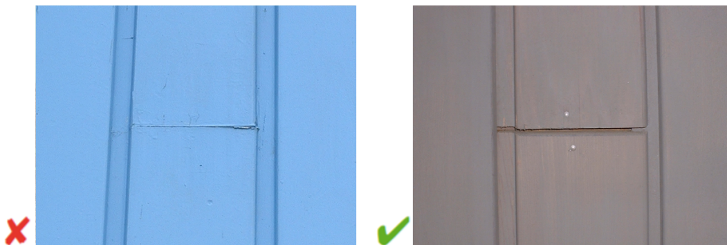
Afbeelding 8 - Stuiknaden fout gemonteerd (Bron: Centrum Hout, 2018)
