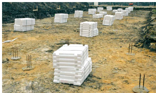
Minder afval en efficiënter in volume bij aanvoer, opslag en verwerking
