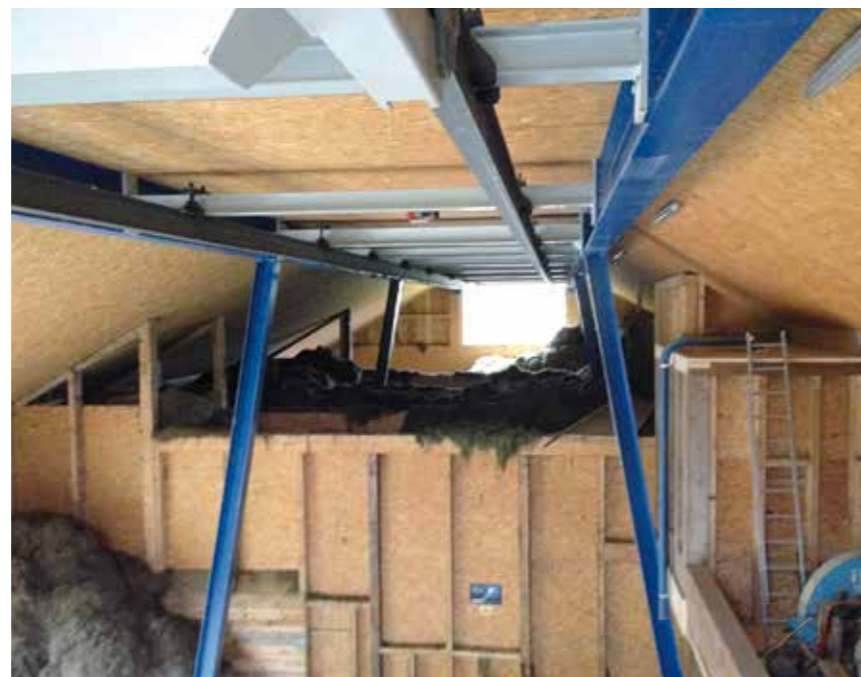
23 Heuboxen mit Abluftklappe
